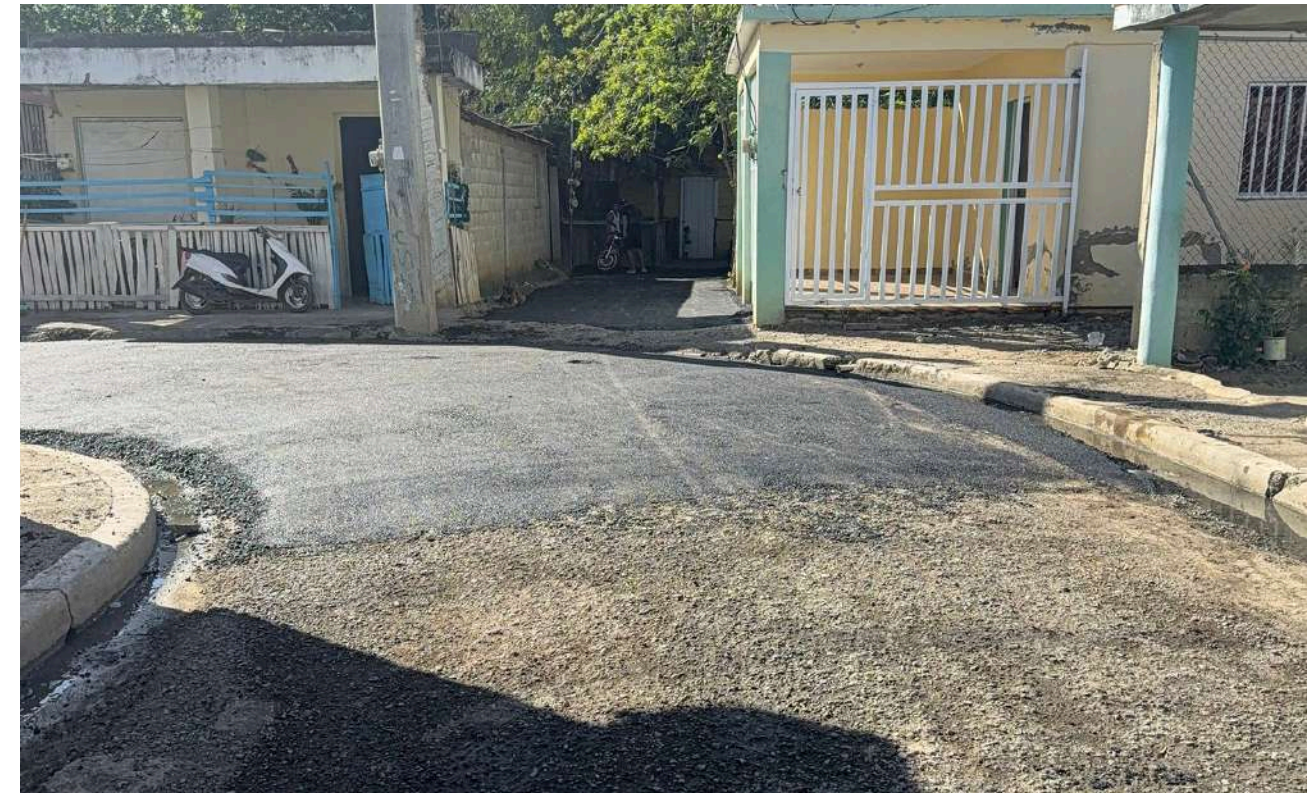
ASFALTO CALLE CAONABO EL MECHON
